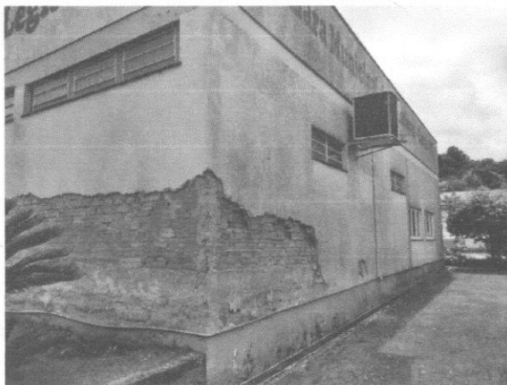
Imagem da fachada externa frontal e lateral, onde o reboco já está sendo removido.
