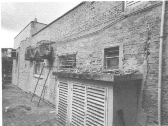
Imagem da fachada externa dos fundos, onde o reboco foi removido.
